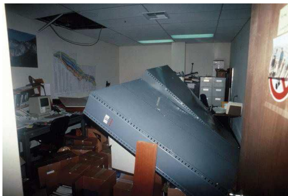
Armaris no fixats a la paret a les oficines del US Geological Survey a Menlo Park, Califòrnia, que van caure durant el terratrèmol de Loma Prieta, 17 Octubre 1989. (De la US Geological Survey Photographic Library a: http://libraryphoto.cr.usgs.gov Diapositiva VI-1 USGS Open File Report 90-547)
