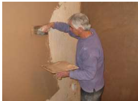
Un operario escayolando una pared (Trabajo cedido al dominio público por su autor, Arpingstone )
