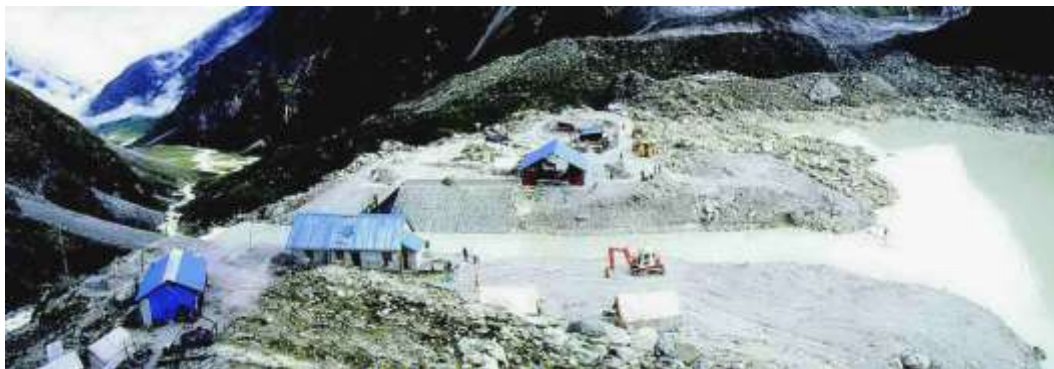
Sobreeixidor i comportes, construïts per controlar la sortida d'aigua del llac format per la presa de la morena, Tsho Rolpa, Nepal (Foto: © RGSL 2009)
