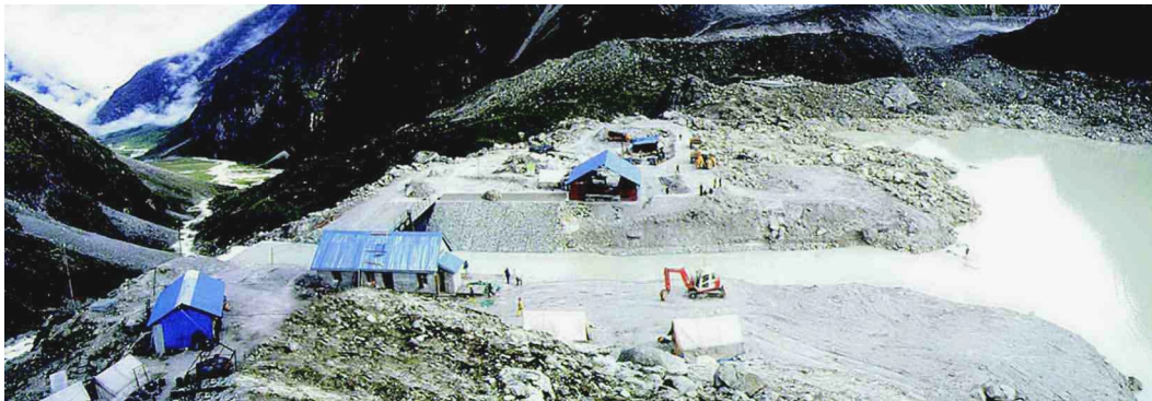
Et avlastningsbyggverk og sluser er bygd for å kontrollere uttømmingen av vannet fra den morenedemte innsjøen i Tsho Rolpa, Nepal (Foto: © RGSL 2009)
