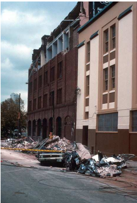
Auto schiacciate dai calcinacci caduti che hanno ucciso 5 persone all'uscita dal posto di lavoro. Terremoto di Lomo Prieta, 17 ottobre 1989. (Dalla Libreria Fotografica del US Geological Survey a: diapositiva 1-1 USGS Open File Report 90-547)
